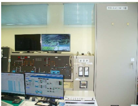
【揖保川 監視制御設備】
