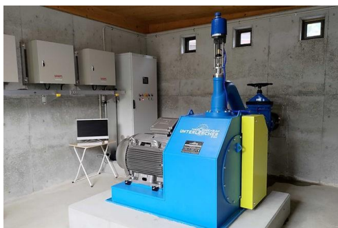
小水力発電所（奥粟市）
