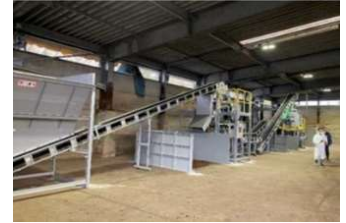
ペレット粒造設備（神戸市）
