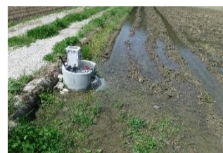
用水路を管路化し遠隔操作型自動給水栓を設置 (丹波市)
