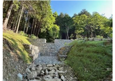
緊急防災林整備(溪流対策)で整備した簡易防災施設(佐用町)
