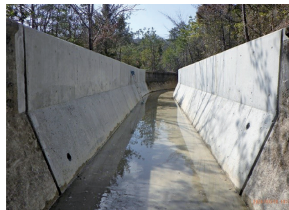
老朽化した用水路の長寿命化対策 (加東市鴨川導水路・国営東条川2期地区)
