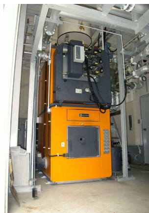
木質バイオマスチップボイラー
