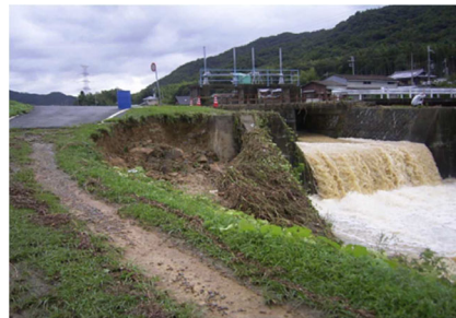
菖蒲池下流の出水状況
