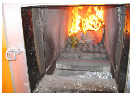
(ボイラー内部)
