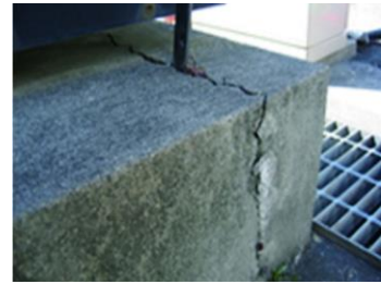
基礎にクラックが入った状態
