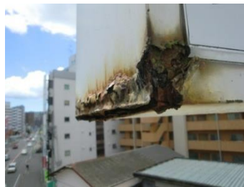
側板の腐食が進行した状態
