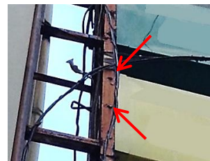
ボルトのゆるみや欠落した状態
