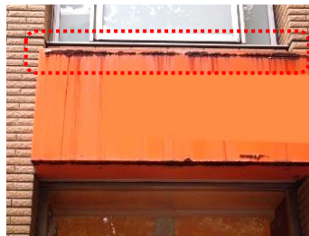
その他（塗装剥離、腐食など）
