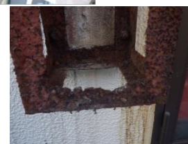
支持部が腐食していた看板の例
