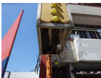
側板底面が欠損した状態
