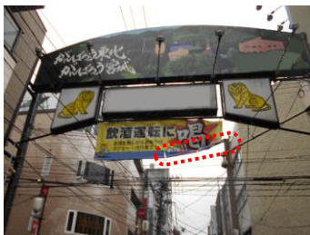
幕材を張る部材が破損した状態
