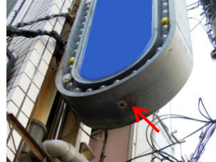
水抜き孔が詰まった状態
