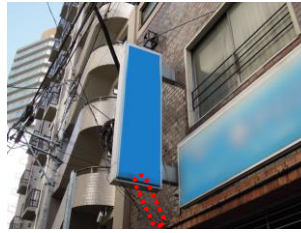
振れ止め棒が変形した状態
