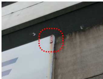
金具が劣化した状態
