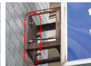
取付部プレートが腐食している状態
