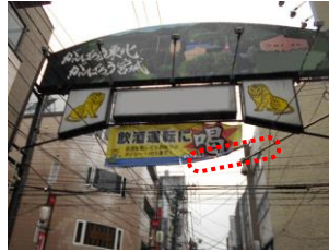
幕材を張る部材が破損した 状態
