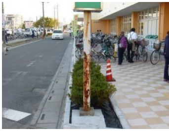
支柱の腐食が進行した状態
