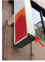
広告板底部の腐食が進行した状態
