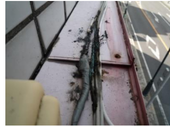
配線が劣化し、ショートした状態
