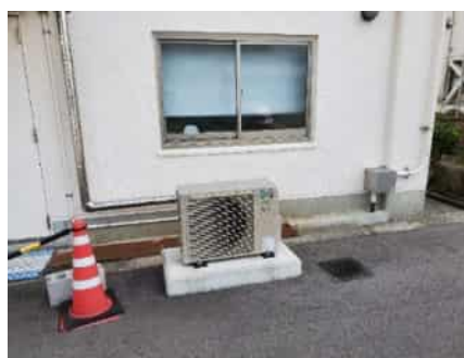
室外機等の高所化（西神戸庁舎）
