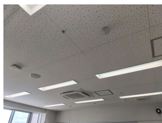
普通教室の空調室内機とLED
