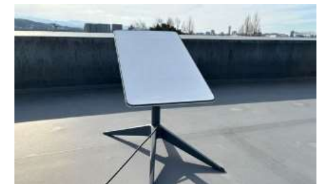
低軌道衛星通信(スターリンク) ※アンテナを置いて電源(非常用自家発電機等)をつなぐのみ
