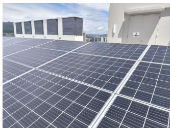
太陽光発電設備
