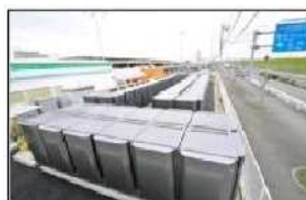
1.2メガワットの燃料電池（SOFC）
