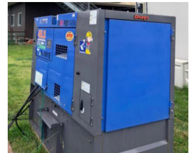
(非常用自家発電設備)
