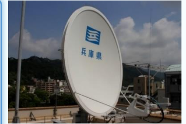
▲衛星アンテナ (災対センター屋上)
